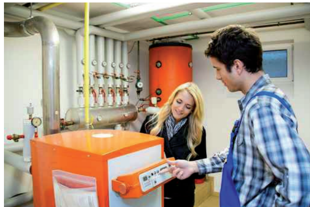
Regelmäßige Prüfung und Wartung der Heizungsanlage verhindert unnötigen Energieverbrauch und damit verbundene Heizkosten.
